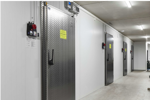
Flur mit Zugang zu Kühlräume
